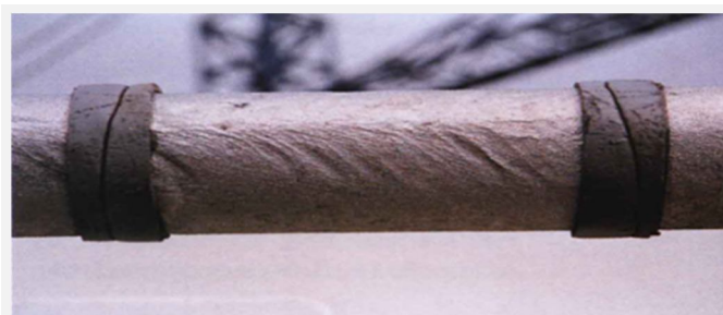
Izolované dopravné potrubie
